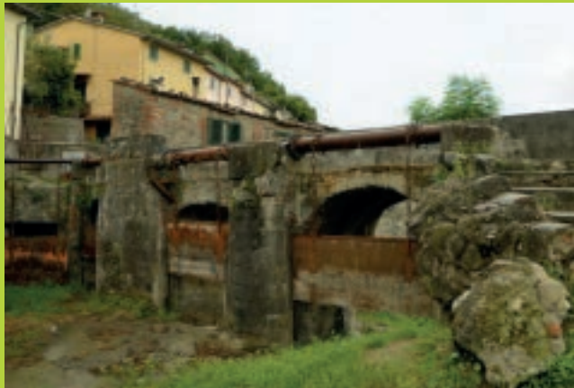
Struttura per la captazione delle acque della Gora di Gora sul Fiume Ombrone presso Capostrada (fotografia L. Nucci).
